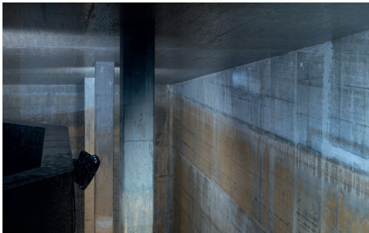
Eine leere Kammer im Reservoir Enzenried, der Quellwasserfassung vom Einzugsgebiet Homberg-Buchen-Teuffenthal, während Wartungsarbeiten.
